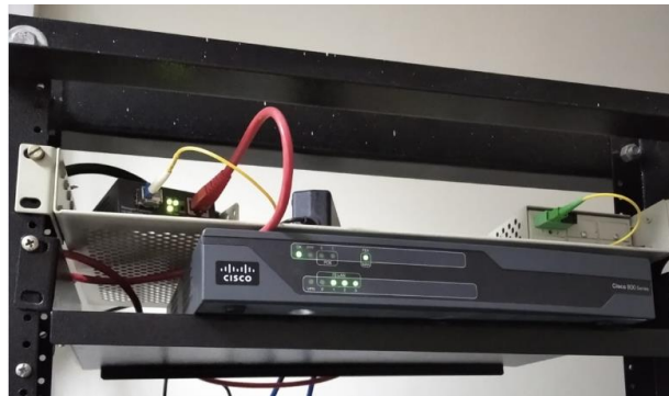
Figura 19.10. Router Proveedor Internet (Instalado).
