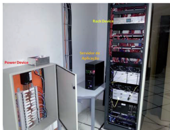
Figura 13: Power Device e Rack Device instalados e operando.
