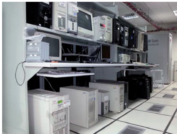
Figura 12: Ambiente de servidores legado do Datacenter do CEPROMAT
