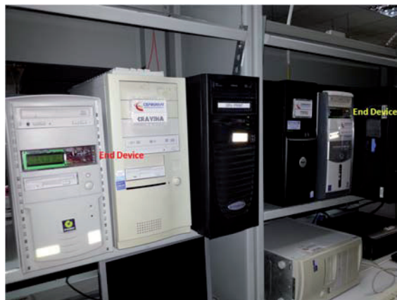
Figura 14: End Devices instalados e operando.
