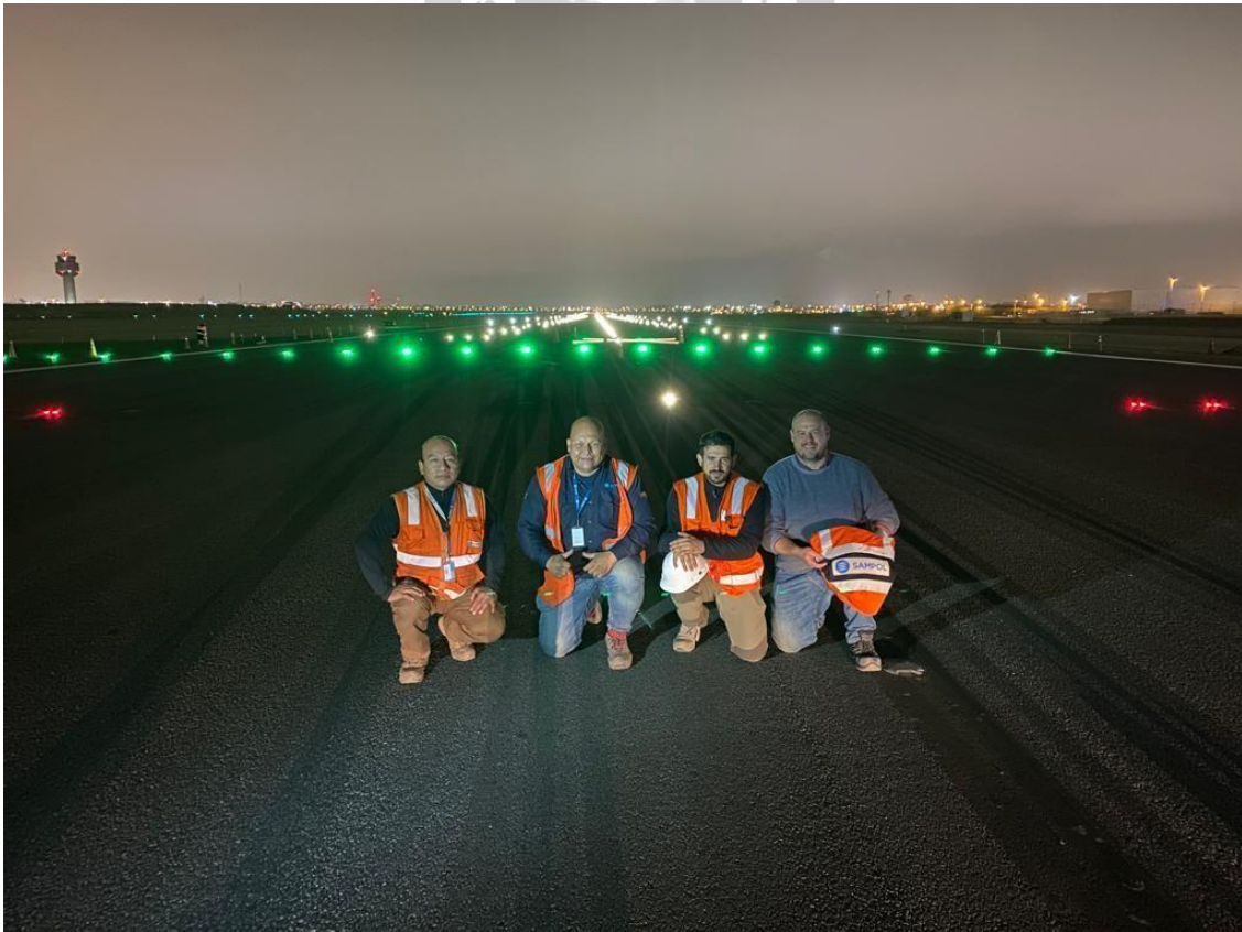
Pruebas Finales de todo el Sistema SCADA y Equipos AGL en la Segunda Pista AIJCH con Ingenieros de Fabrica ADBSafegate (Bélgica – USA) y SAMPOL (España).
