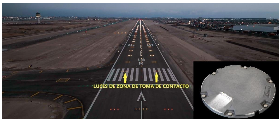
Figura 4.75: Equipo y Luces de Zona de Toma de Contacto instalación del AIJCH. (Fuente: E. Propia)
