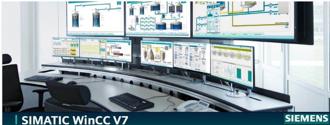
Figura 4.12: Imagen de entorno con SIMATIC WinCC SCADA. (Fuente: Siemens)
