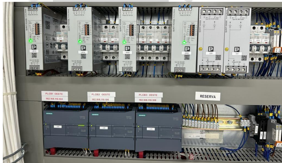
Figura 4.49: PLC Siemens S7-1200 en gabinetes de Sala Oeste. (Fuente: E. Propia)
