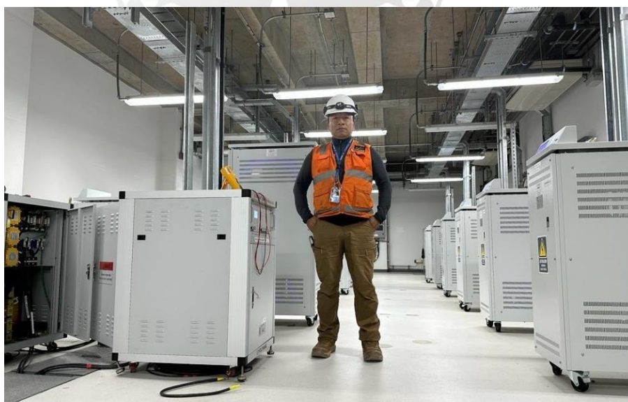
Figura 4.67: Subestación Oeste con Reguladores CCR VIS en Instalación (Fuente: E. Propia)
