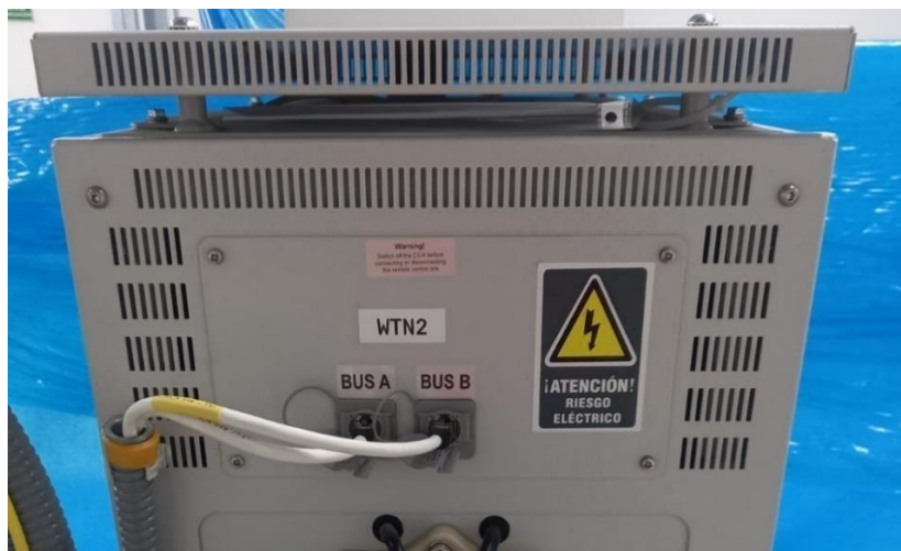
Figura 4.63: Conexión de Cables Ethernet en Reguladores CCR (Fuente: E. Propia)
