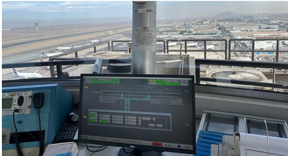
Figura 4.45: Estación HMI en ATC Torre Actual. (Fuente: Elaboración Propia)
