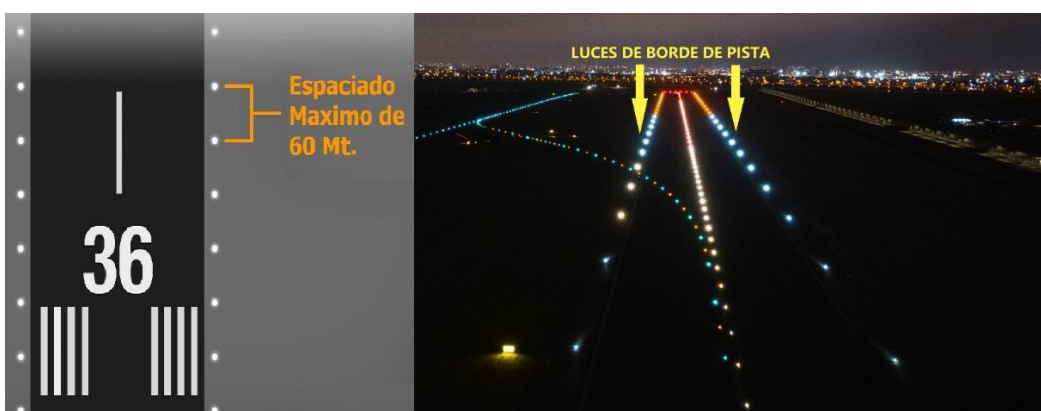
Figura 4.73: Luces de Borde Pista en la instalación del AIJCH. (Fuente: E. Propia)
