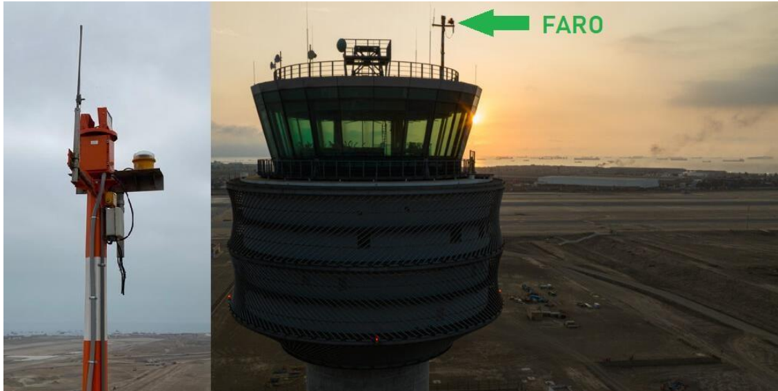
Figura 4.81: Vista de ubicación de Faro en la Torre de Control. (Fuente: E. Propia)
