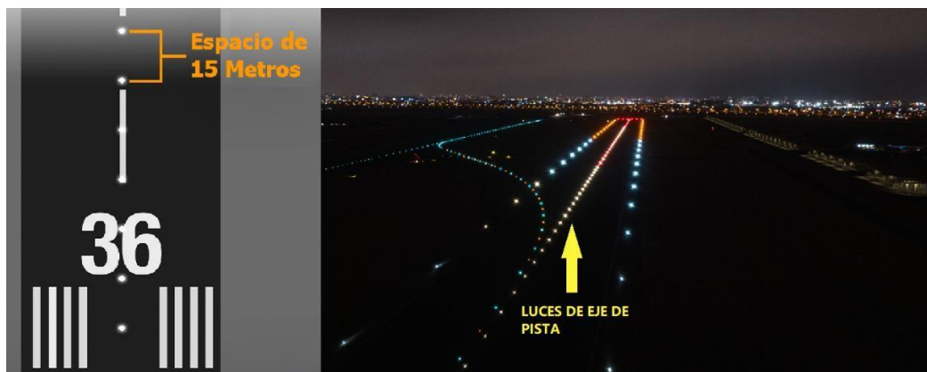
Figura 4.72: Luces de Eje de Pista en la instalación del AIJCH. (Fuente: E. Propia)
