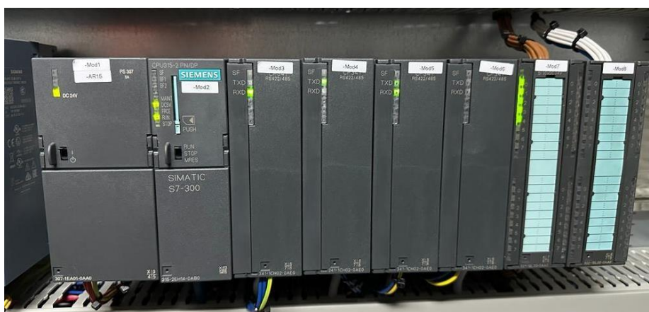
Figura 4.51: PLC Siemens S7-300 CPU 315-2. (Fuente: E. Propia)
