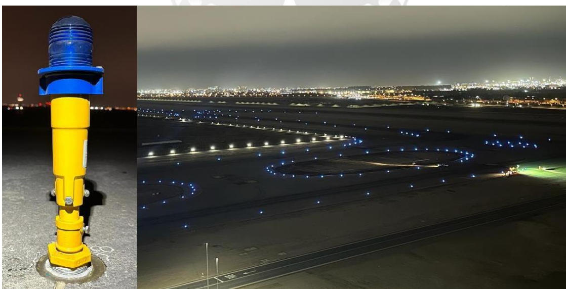
Figura 4.77: Equipo y Luces de Borde de Calle de Rodaje instalados en el AIJCH. (Fuente: E. Propia)
