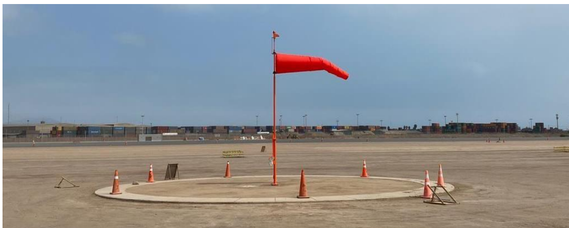
Figura 4.82: Vista de Cono de Viento instalado en AIJCH. (Fuente: E. Propia)
