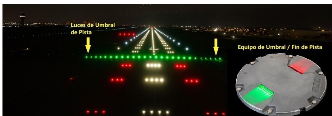
Figura 4.74: Equipo y Luces de Umbral / Fin de Pista en la instalación del AIJCH. (Fuente: E. Propia)
