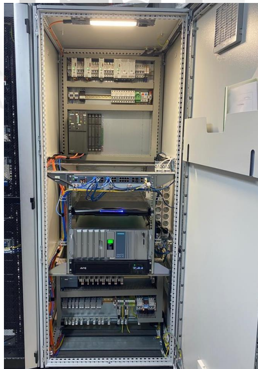
Figura 4.48: Servidor Siemens SIMATIC IPC547J y PLC Master S7-400H instalado en Gabinete ATC. (Fuente: E. Propia)
