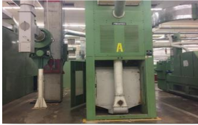
Figura 3. Maquina Aeromix Fuente: Planta Creditex - Pisco
