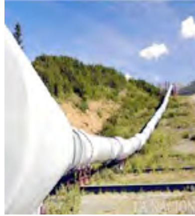
GASEODUCTO ( gas pipeline )
