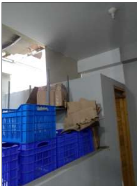
Figura 14. Desorden en el área de trabajo
