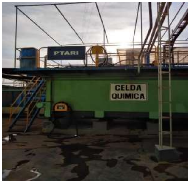
Figura 19: PTARI (planta de tratamiento de agua residual industrial)
