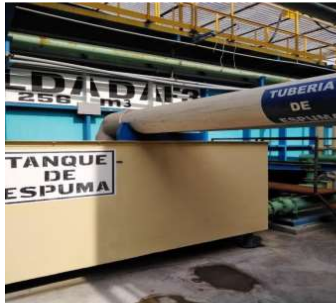
Figura 18: Tanque de espuma del DAF.
