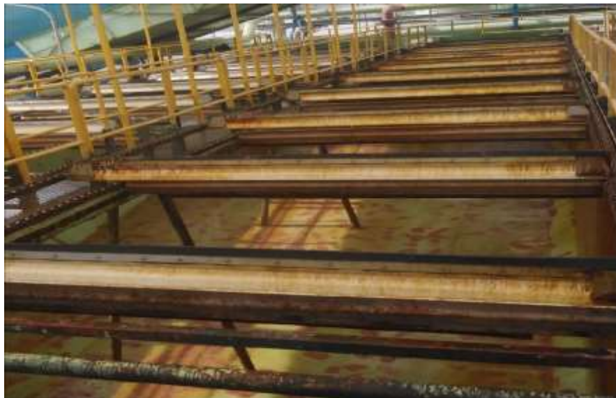
Figura 28: Celda de tratamiento físico llena de grasa.
