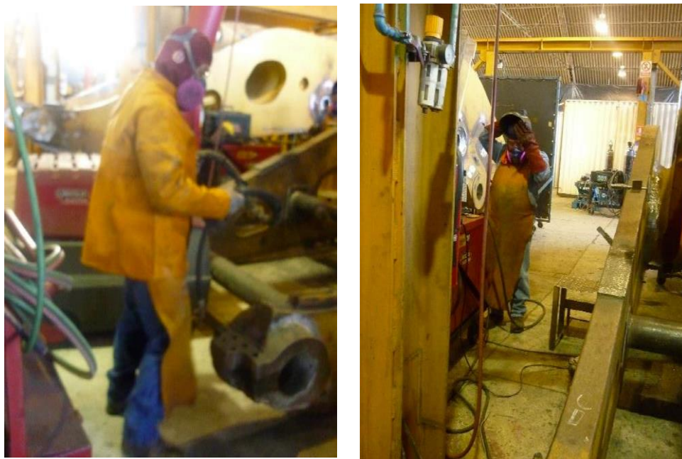
Figura 19 No Conformidad Menor - Hallazgo 3
