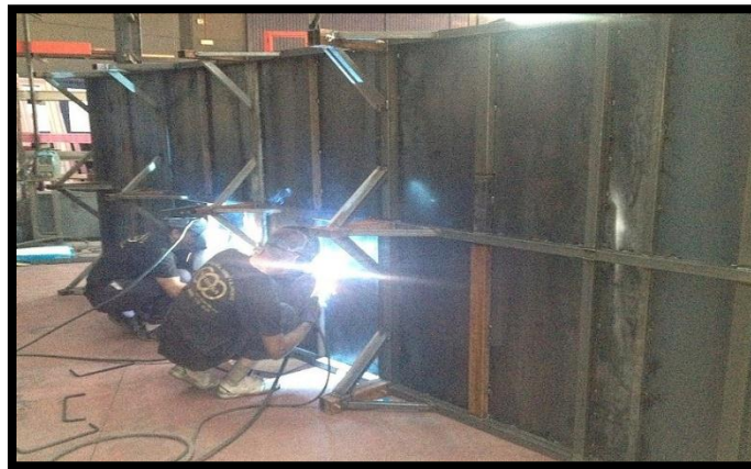
Gráfico 12. Personal expuesto a riesgos como caídas de nivel
