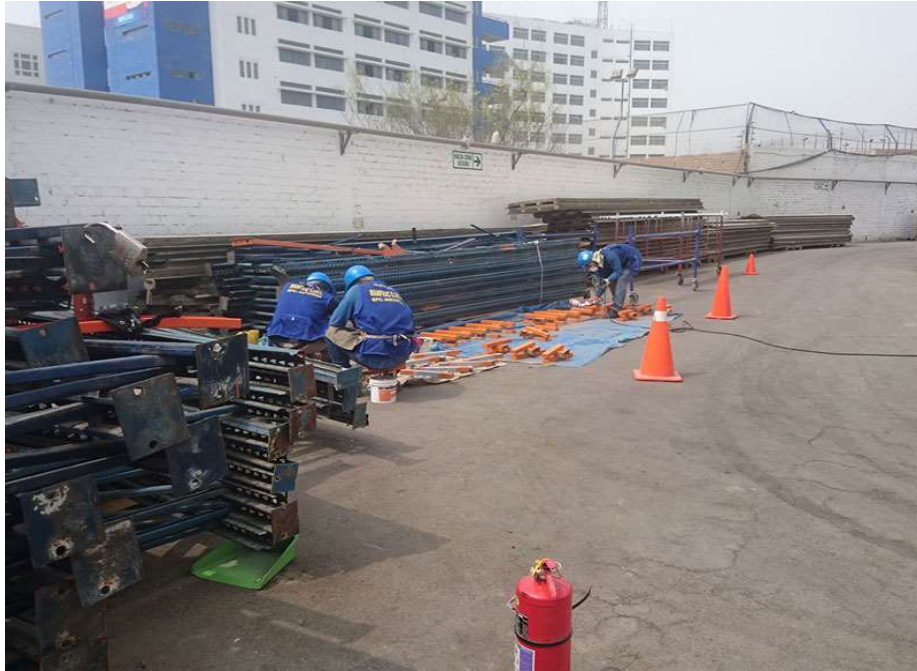
Mantenimiento de racks
