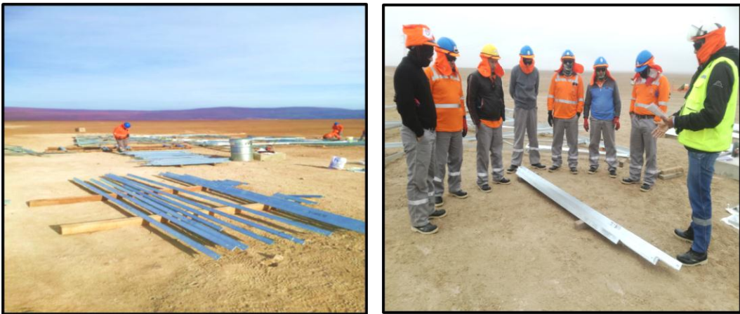
Figura 6. Preselección y distribución de piezas metálicas. Fuente: Fotografía tomada en la etapa de Prearmado
