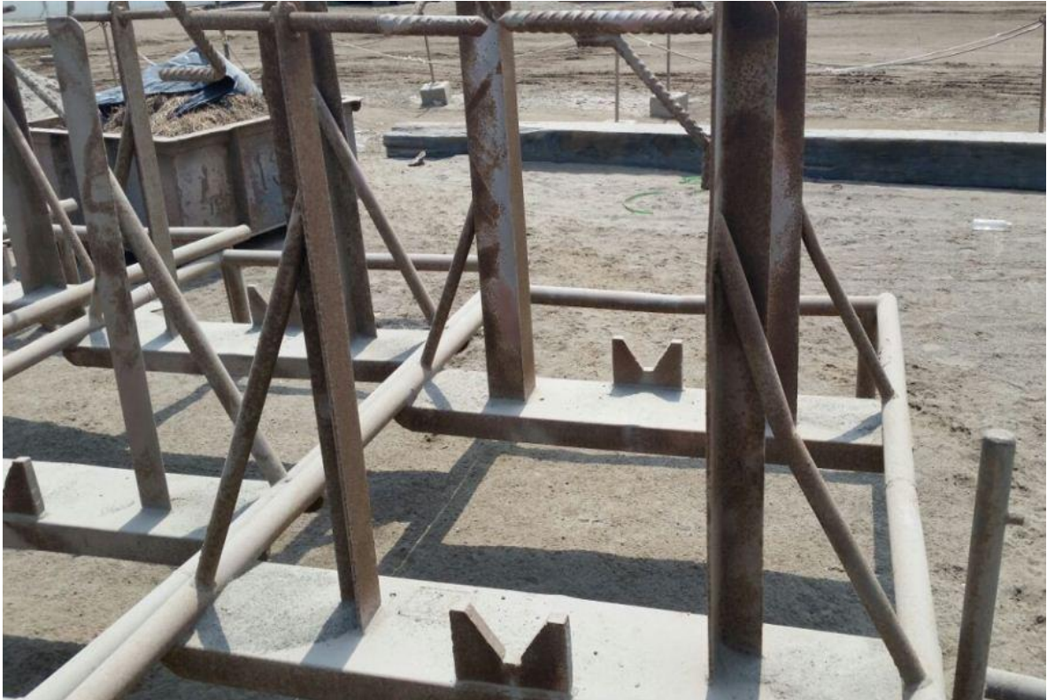
Fig. N° 39: Vista Lateral del Prototipo de la Base para Arenado y Pintado de Planchas de Acero del Proceso propuesto.
