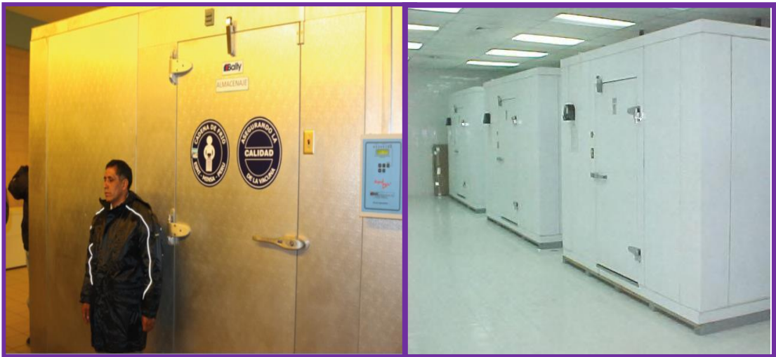
Fig. 1: Cámara frigorífica para mantener temperaturas de refrigeración y/o congelación
