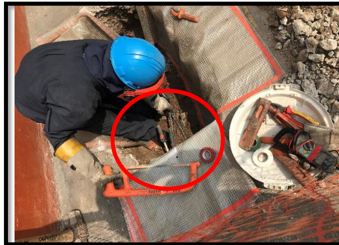
Figura 39. Implementación de Capuchones Fuente: Fotografía Propia.
