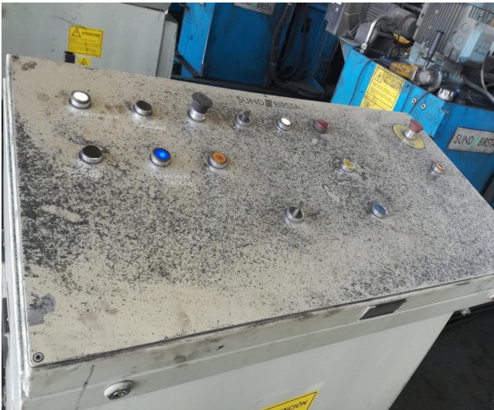
Figura 22 Presencia de laminillo en equipos de planta
