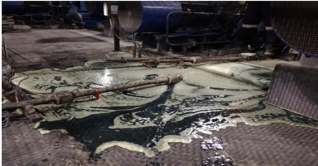
Figura 25 Derrames de aceites en equipos de planta
