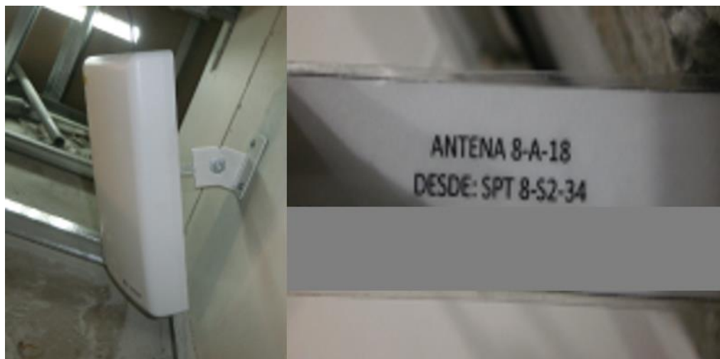
Figura 24: Antena Panel instalada en el edificio X con su respectiva etiqueta Fuente: Elaboración Propia
