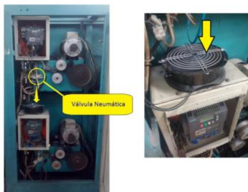
Montaje incorrecto. Al condensarse gotas de agua, estas se filtran por la rejilla de ventilación.
