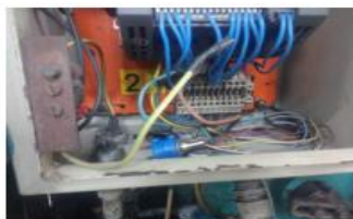
Acumulación de suciedad
